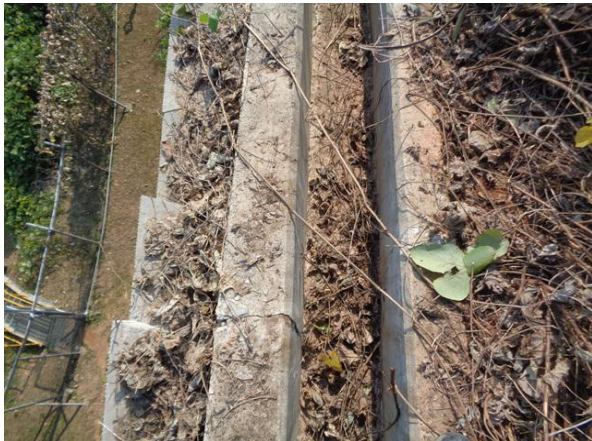
주변영향인자 S2 균열( C_w=0.3\text{mm} 이상)
