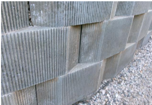
전면부 S17 블록 균열
